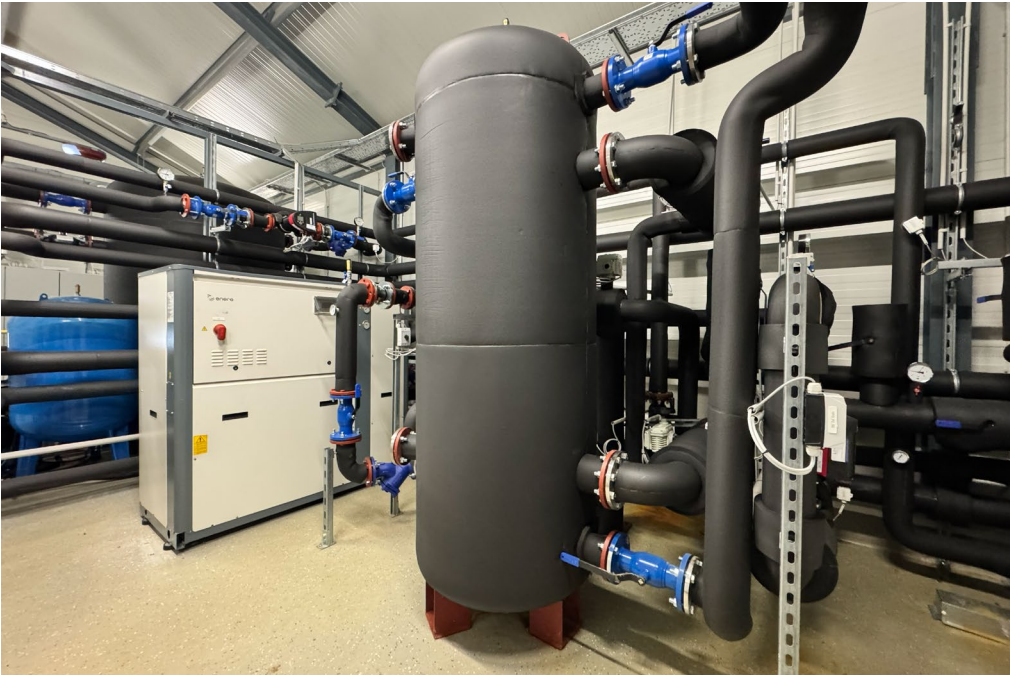
Kaposvári Jégcsarnok hulladékhő-hasznosítás, Fotó: Bakos Balázs
